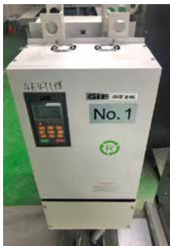
▲加裝裝電梯能源回收器
