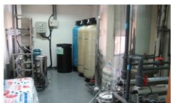
洗腎室RO製程廢水回收 每小時廢水量約為4-5噸
