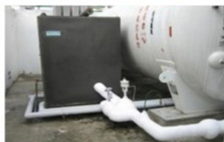
液氧槽再生能源回收 回收約12噸空調冰水再利用
